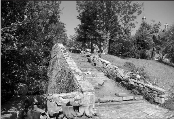
L'escalier monumental vu de la terrasse du bastion après nettoyage de la végétation.
